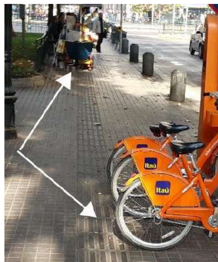
Elementos que interfieren en el pavimento podotáctil.
