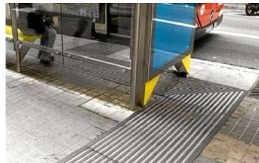
Varias imágenes de pavimentos podotáctiles mal instalados o que posteriormente se han instalados elementos a su paso, que nos dirigen contra una farola, un árbol o la marquesina de un autobús.
